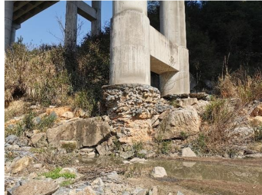
图 3-1: 桩基裸露正面照
