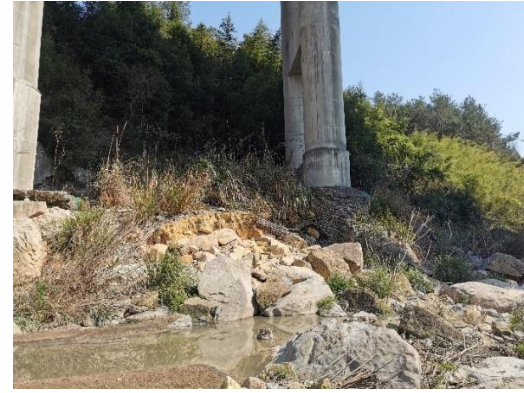
图 3-2: 桩基裸露侧面照
